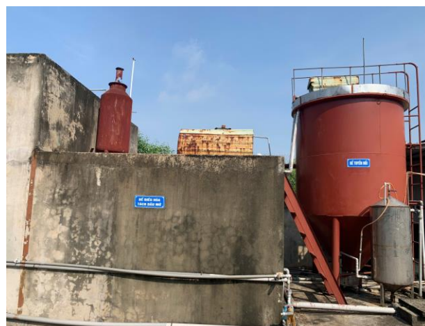
Bể điều hoà và bể tuyển nổi
