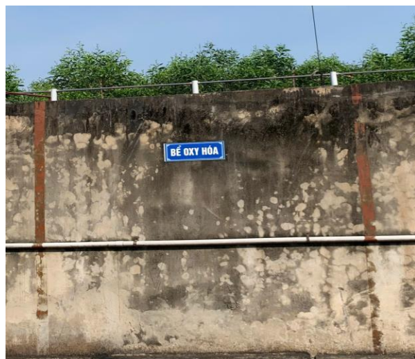
BỂ Oxy hoá
