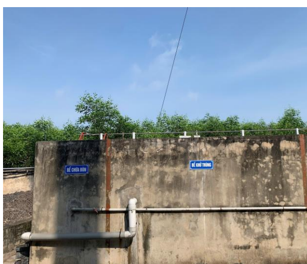
BỂ khử trùng và bể chứa bùn
